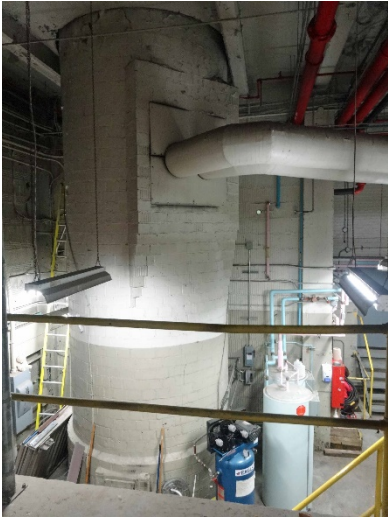
9a. boiler room interior
