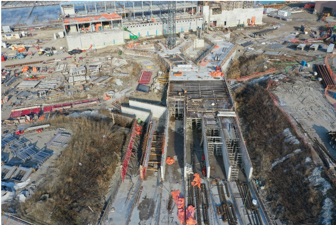
Figure 7 – Final Effluent Conduits
